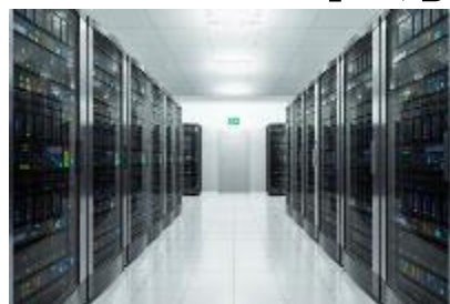
データセンター
